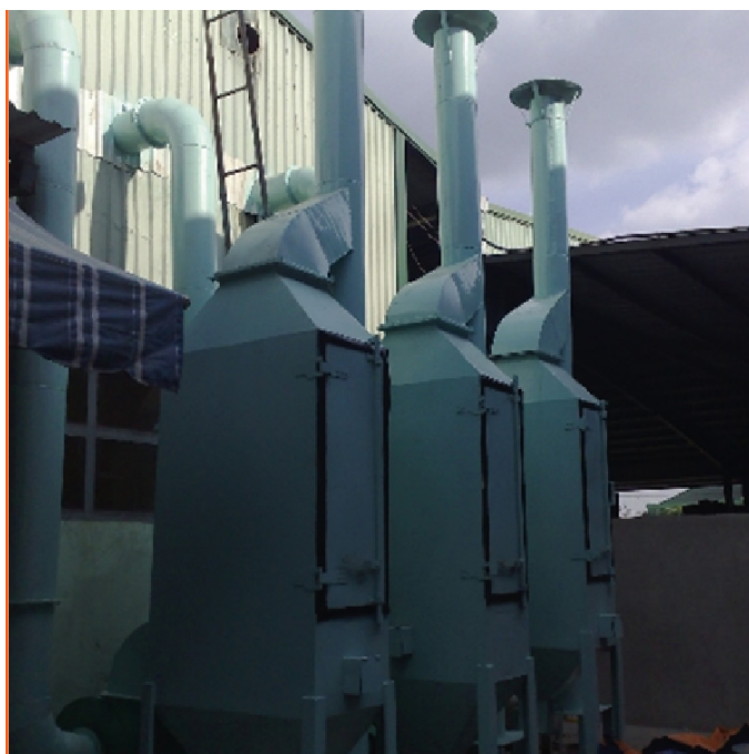
Hệ thống hút bụi nhà xưởng
