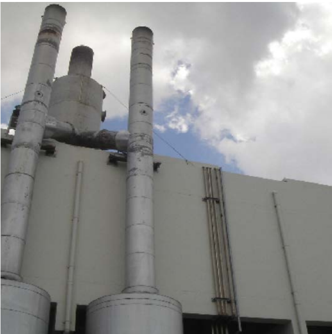
Hệ thống xử lý khói máy phát điện
