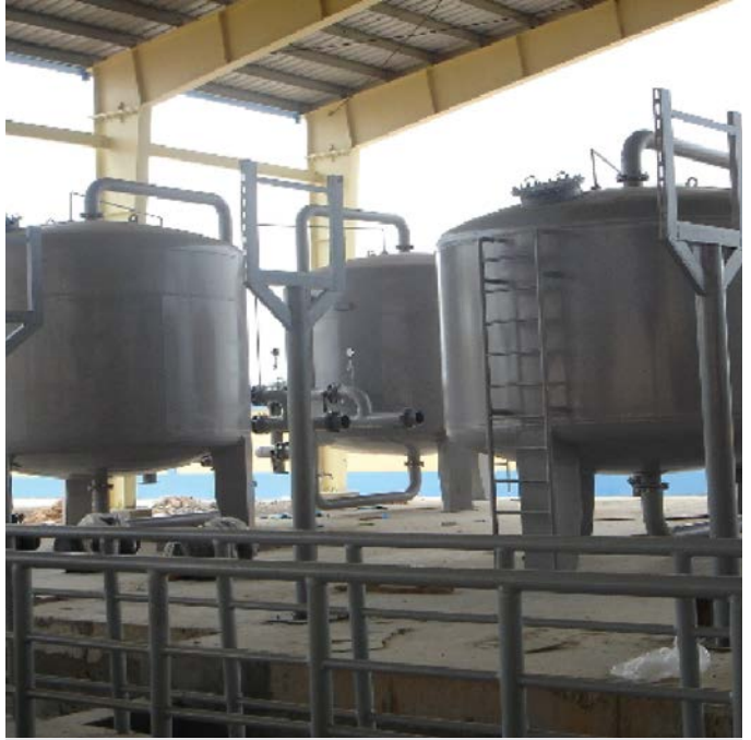
Hệ thống xử lý nước thải công nghiệp
